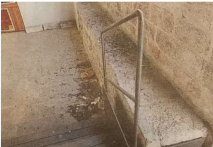
Ingresso a Palazzo Monte Frumentario. Servizio di pulizia non previsto nell'appalto (foto dal Corriere dell'Umbria )
