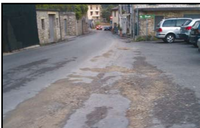
Strada di San Vitale: esempio di scarsa manutenzione del manto stradale
